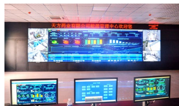
通用技术中国医药所属天方药业引进国内先进的技术和设备，先后高标准建设废水处理站（自动化控制中心）、废气处理系统，以及自动化能源调度中心，发展循环经济，逐步实现“动力节能，发酵节电，能源循环使用”目标
